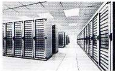
Hình 1.8. Hệ thống các máy chủ lớn chứa dữ liệu
